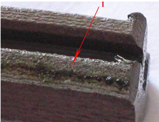
в) оксидообразные коррозионные поражения на границе покрытие-основа
